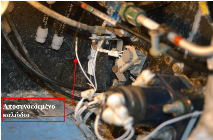
Φωτ. 4. Το καλώδιο προς τον ηλεκτρονόμο
