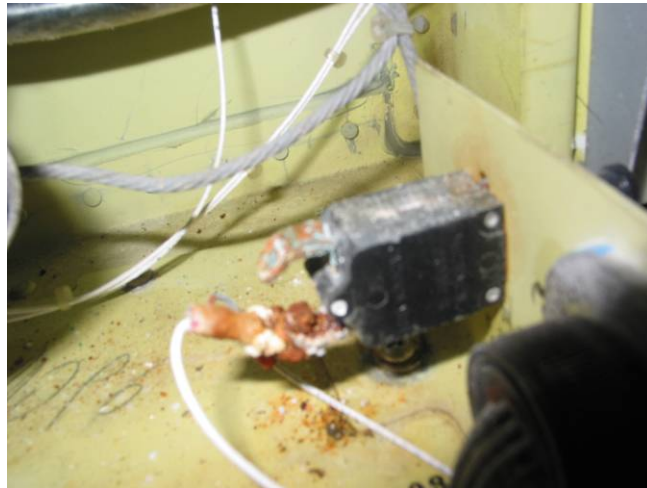
Φωτ. 8. Αυτόματος του ECU Test
